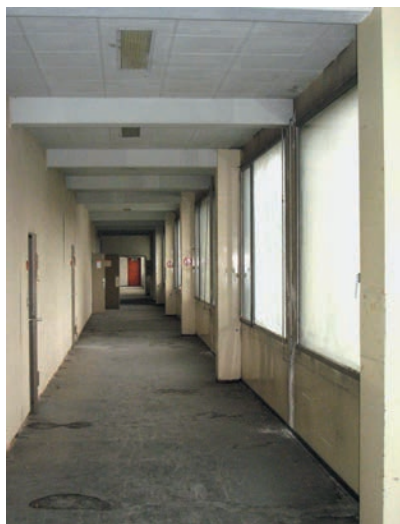
Abb. 13 Flurbereich und Fenster der Westfassade, Bestandsschäden, 2014
