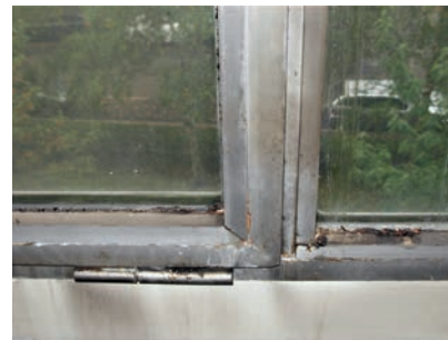
Abb. 14 Westfassade, Flurfenster, Bestandsschäden, 2014
